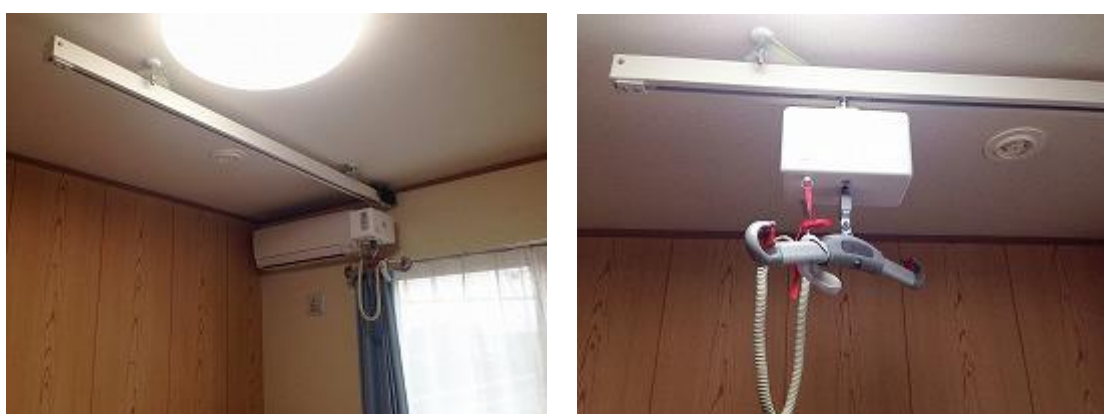
ショートステイの部屋に設置されたリフト。ベットと車いすの間の移動に使います
