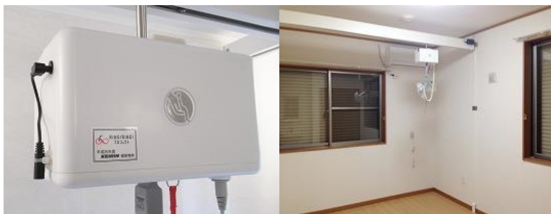
写真左：リフトの上下作動するための駆動部分 写真右：1階居室に設置されたリフト
